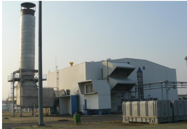
Obr. 4 Celkový pohľad na odvod plynov z motora RB211 DLE kompresorovej stanice
