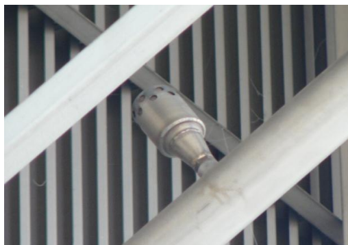
Obr. 7 Detail dýzy privodu teplého vzduchu umiestneného v priestore systému privodu vzduchu do TKM RB 211 DLE kompresorovej stanice
